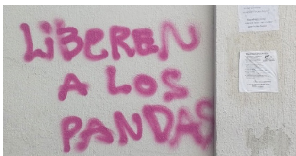
Imagen 9. Rayados sobre fachada, en Calle Grajales con Vergara, Barrio República Fuente: Elaboración propia
